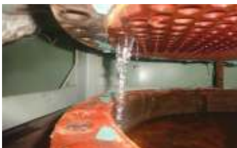
Gambar Kebocoran pada Pipa Evaporator FWG
