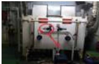
Gambar 8. Valve ekspansi tank rusak
