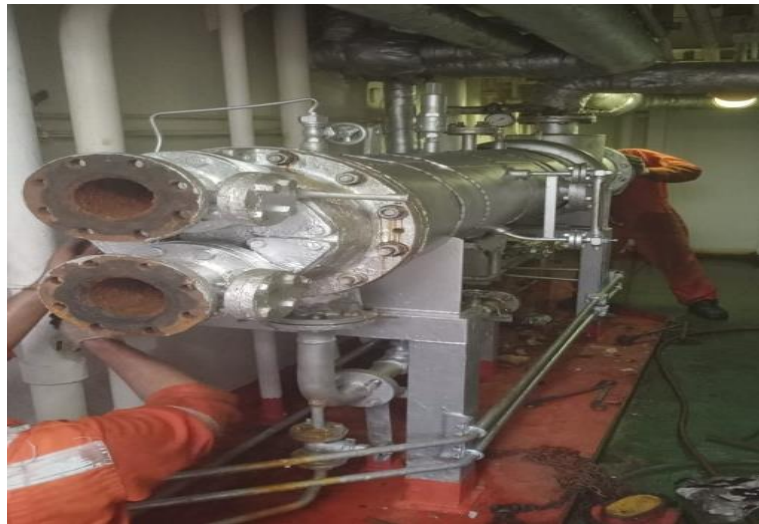
Figure 5. Proses pengecekan pada tank cleaning heater Sumber : Dokumentasi Penelitian
