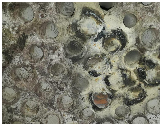
Figure 4. Pengikisan pada pipa api Boiler akibat korosi Source : Dokumentasi Penelitian
